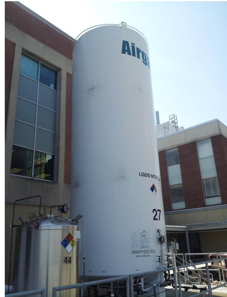
9000 Gallon tank at 222/ESB
