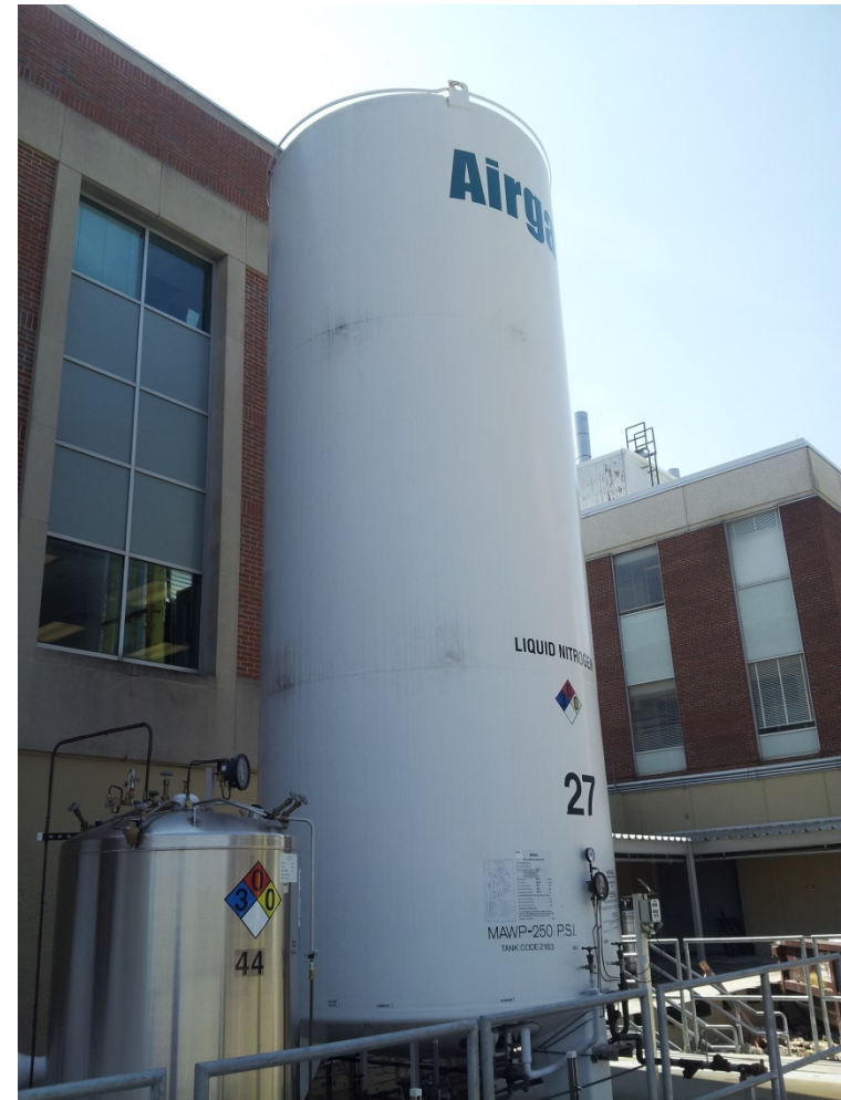
9000 Gallon tank at 222/ESB
